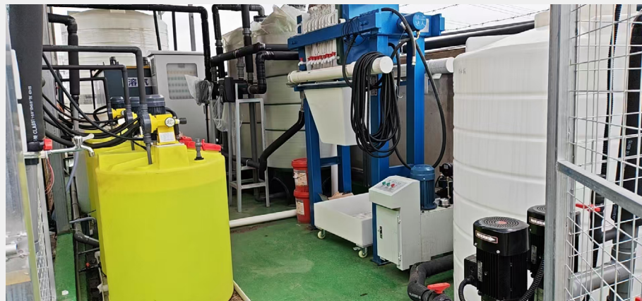
污水處理設備
